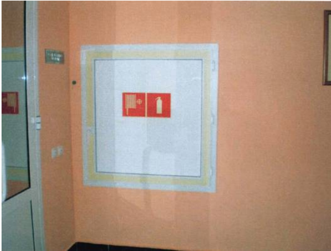
Рисунок А.6 - Обозначение фотолюминесцентной 50-мм лентой контура пожарного оборудования и использование знаков пожарной безопасности
