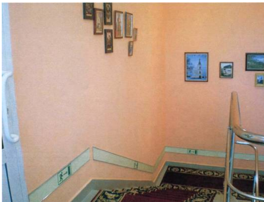
Рисунок А.5 - Вариант ФЭС с использованием направляющей линии шириной 100 мм и эвакуационных знаков направления движения
